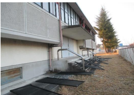
落下した体育館の窓枠
