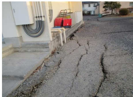
校舎外側の亀裂
