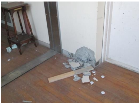
ジョイント部分の亀裂
